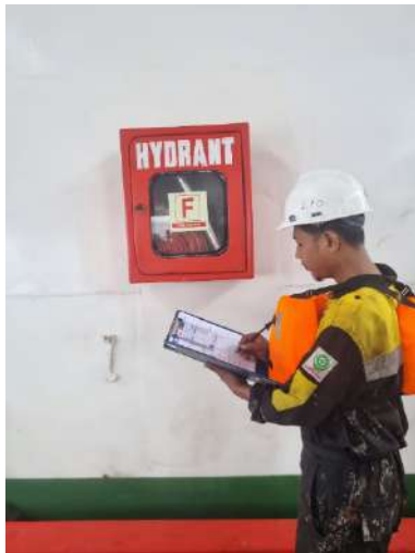
Pemeriksaan fungsi hydrant spray dan selang nosel
