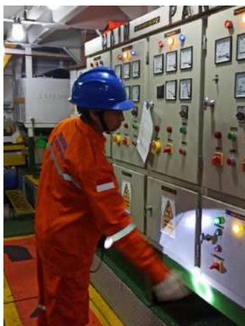
Pengecekan rutin aliran listrik
