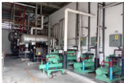
RUANG MESIN & COMPRESSOR
