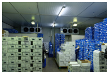
CHILL ROOM DIVISI PASTEURISASI
