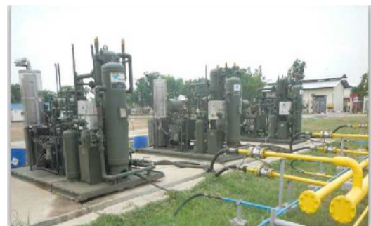
MINI GASJACK COMPRESSOR MILIK PERSEROAN YANG TERPASANG DI PT PERTAMINA EP ASSET 3 SUBANG
